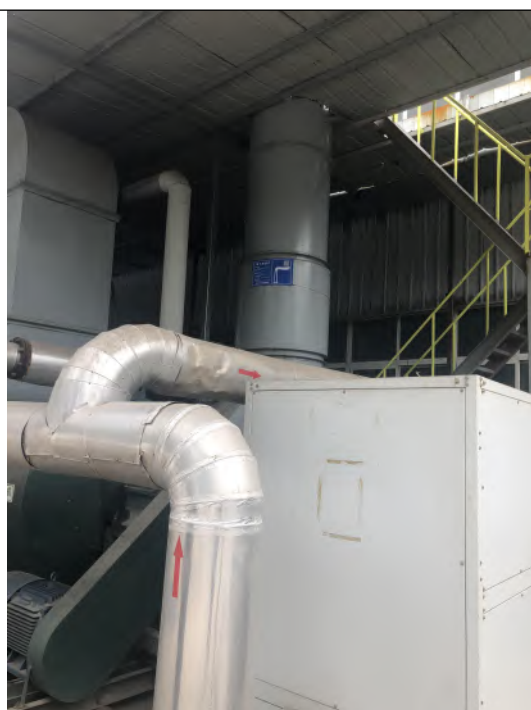
排气筒及排污口标志
