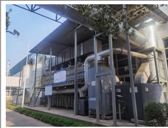
1#车间现有环保设施
