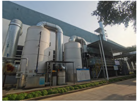
3#车间现有环保设施
